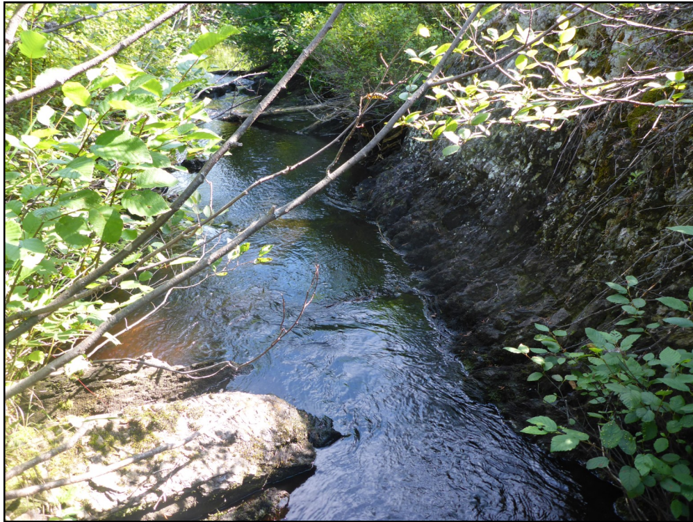
Photo 7 Talus d'une hauteur de 2 m, segment S03, cours d'eau CE06A (2016)
