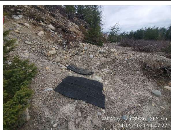
Photo 18. Station A06 – Milieu perturbé – Érosion
